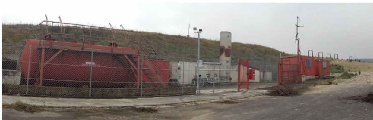
Figure 7: Photographie de l'unité de traitement des lixiviats et des biogaz. Source : Volet III A - Dossier technique
