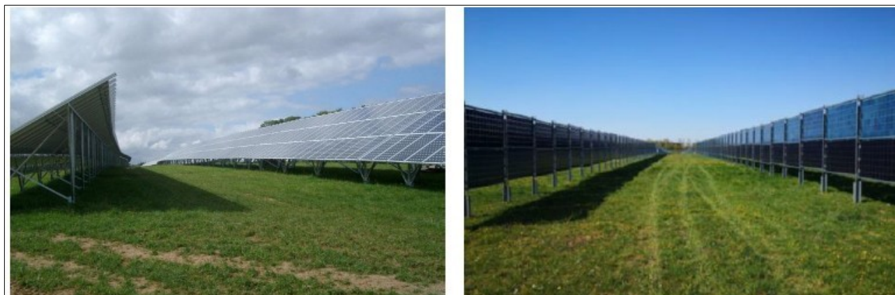
Rangées de panneaux inclinés (à gauche) et verticaux (à droite)
