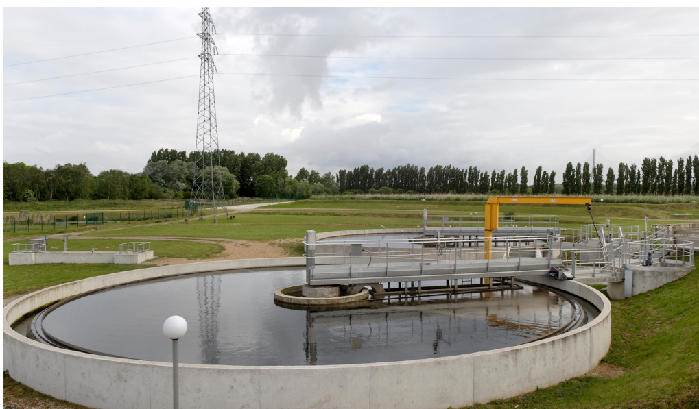
Installations de traitement des eaux usées de la station d'épuration de Honfleur (14) Laurent Mignaux / Terra
