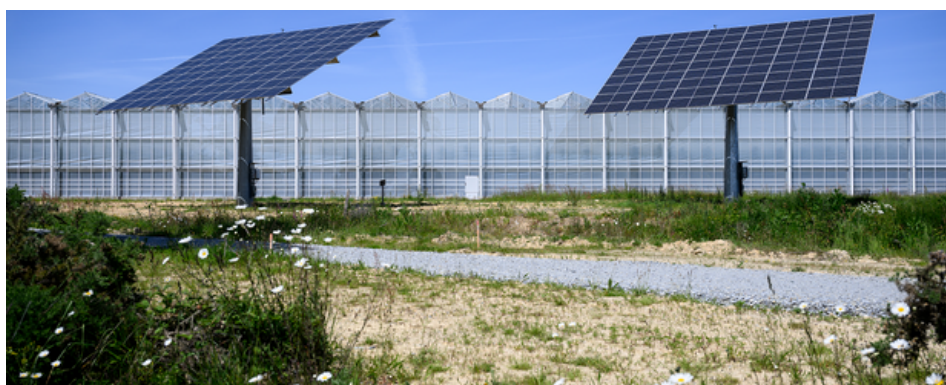
Panneaux solaires - Arnaud Bouissou / Terra
