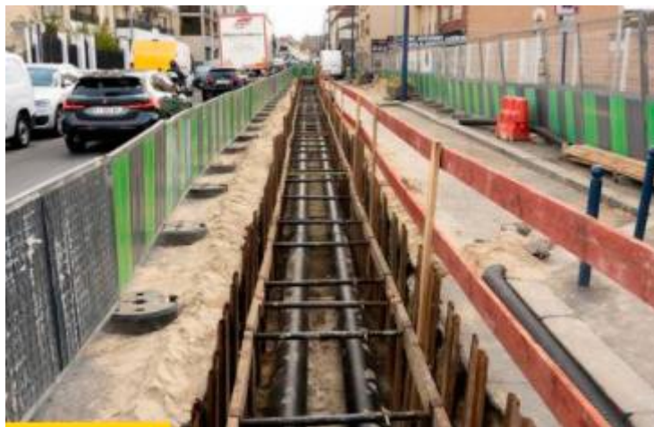
Figure 7: Exemple d'un chantier sur le réseau de chaleur enterré. Source : Étude d'impact, p. 140.
