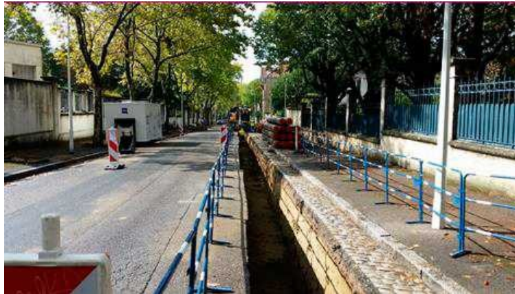
Figure 8: Exemple de travaux par tranchées nécessaires à la mise en place d'un réseau de chaleur urbain. Source : Étude d'impact, p. 147.
