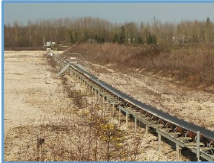
Figure 4 – bande transporteuse terrestre
