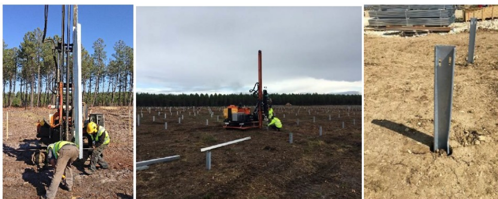
Figure 45 : Exemples de mise en place des pieux battus sur les chantiers URBASOLAR
