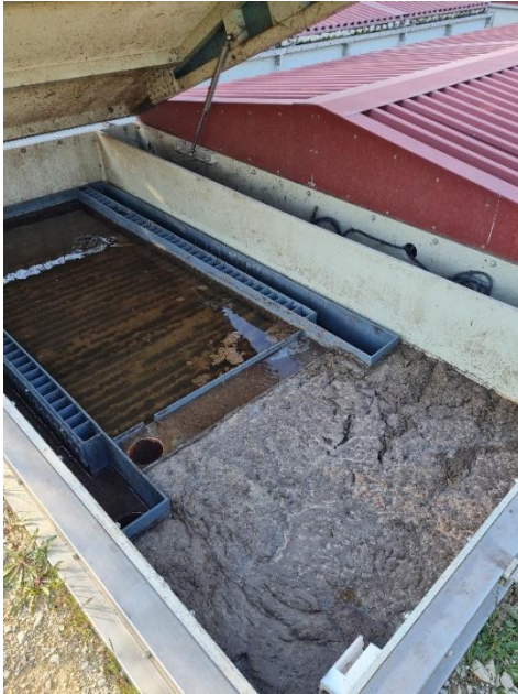
Figure 22: Décanteurs lamellaires de la STEP de Roaix
