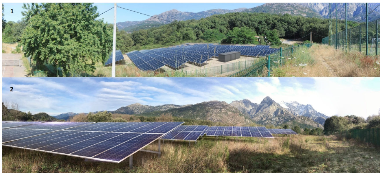
Figure 7 : photomontages des entités ouest (1) et est (2) du projet en vue proche (source : étude d'impact)
