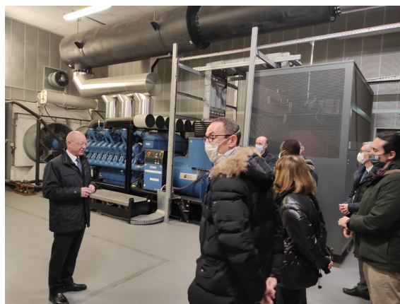
Visite d'un data-center par la MRAe et des membres de l'Ae de l'IGEDD à La Courneuve (93) en janvier 2022. © MRAe-Idf
