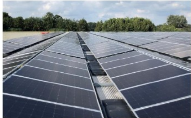
Flotteurs en toiture
